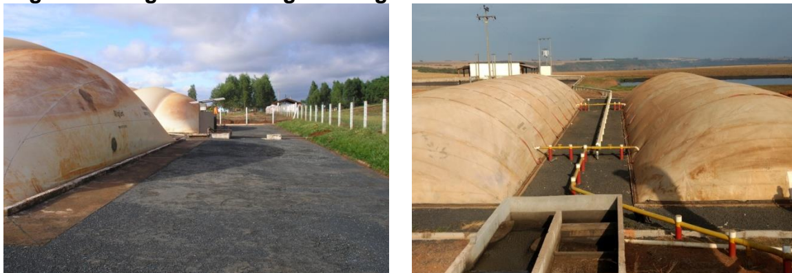
Imagem 2: Imagem de Biodigestor lagoa Coberta.
