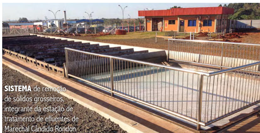
FLOTADOR , em Medianeira, garante o tratamento de todo efluente gerado no processo industrial
