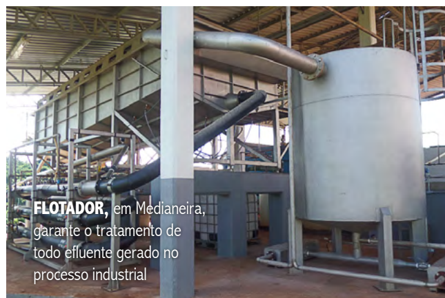
FLOTADOR , de Matelândia, sistema garante qualidade dos efluentes para retorno ao meio ambiente
