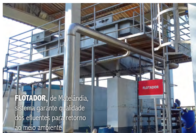
SISTEMA de tratamento primário, em Matelândia, busca remover os sólidos dos efluentes líquidos
